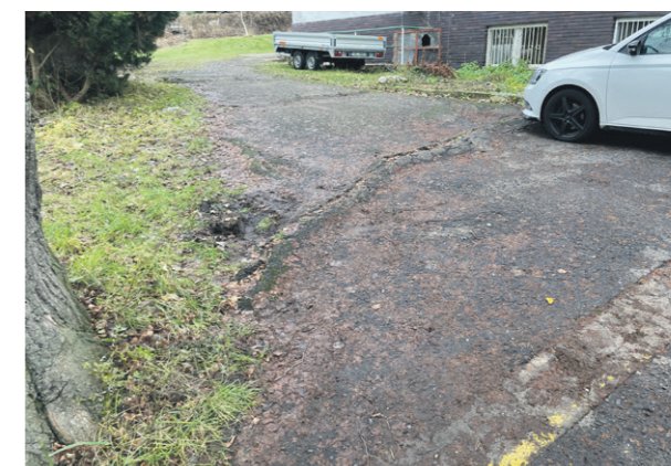
05 STROMY PŘED ŠKOLOU ZALITÉ DO ASFALTU
