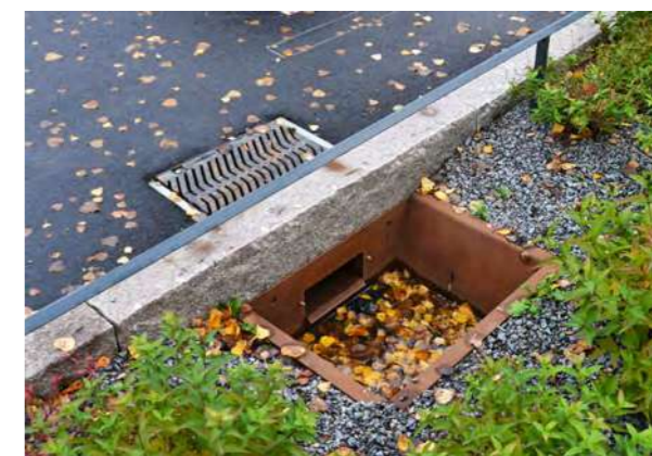
vedení dešťové vody pomocí vpusti a separační vany
